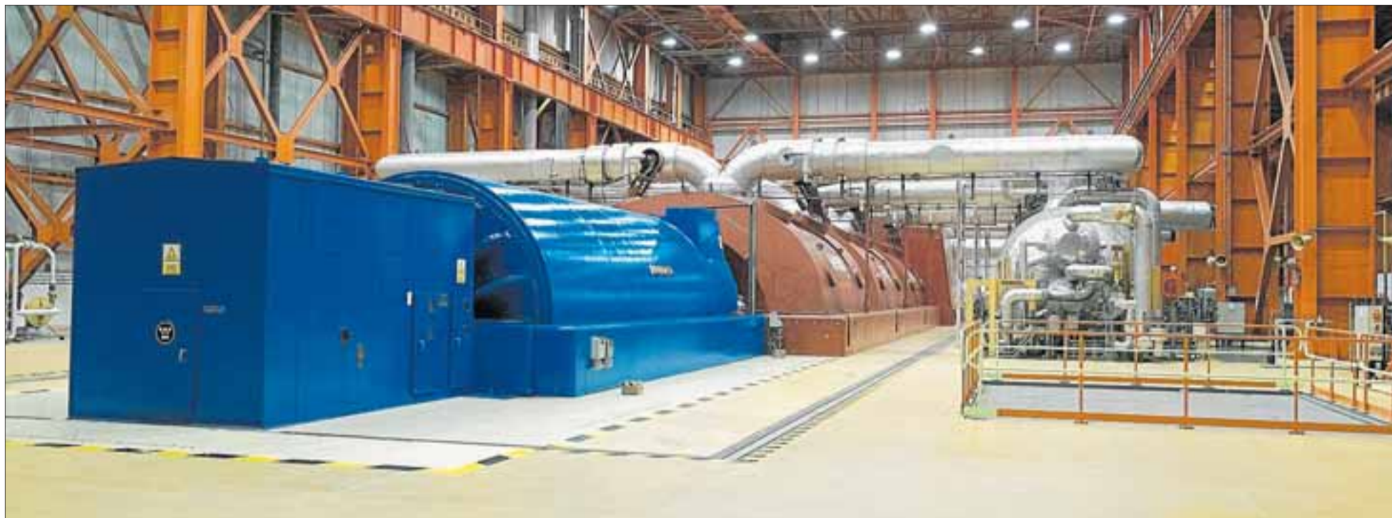
La turbina de Vandellòs-II, en una imatge cedida per la pròpia central. Les mesures de seguretat són molt estrictes i hi ha diverses zones restringides en que no se poden captar imatges.
